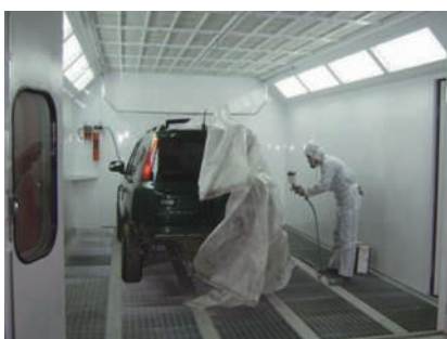
Locali a rischio d'incendio Premises with risk of fire
